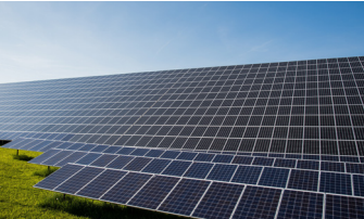
| 厦门自贸片区港务电力光伏项目
