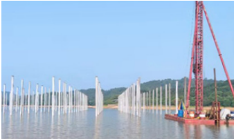
| 大唐华银湘潭石坝口水库光伏项目
